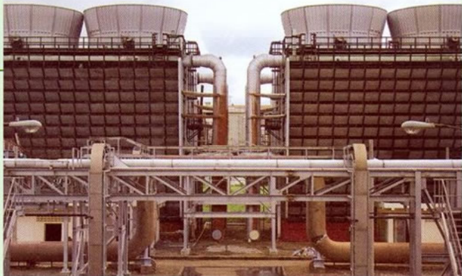
Torres de resfriamento são as vilãs do consumo de água no setor
